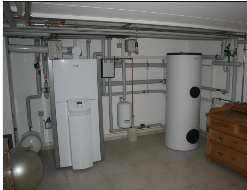
Geräteinstallation im Keller
