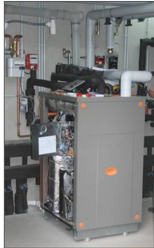
Geräteinstallation im Heizungsraum
